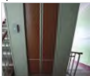
Лифты и подъемники.
