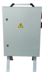
Щит механизации ЩМ- РУСП-100-1x16/5+3x32/5 IP54
